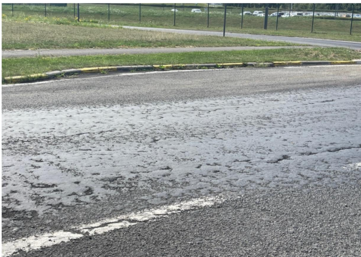
Ernstige schade aan de weg
